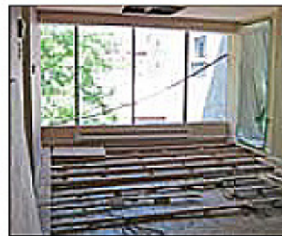
Un aperçu des dommages majeurs subis sur l'avenue Notre-Dame.
